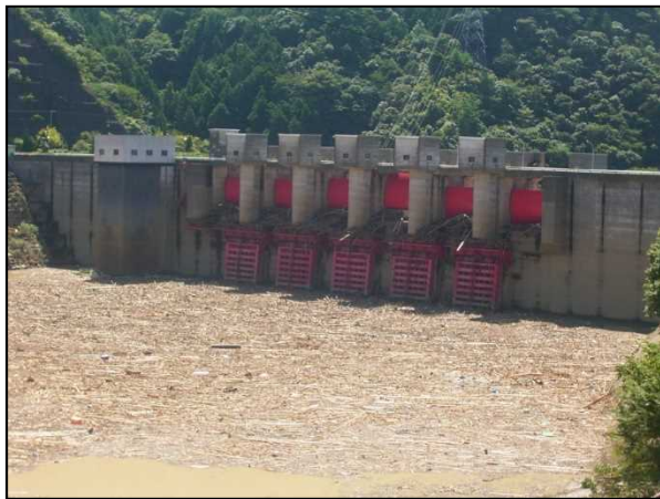
ダムに貯まった流木 (椿山ダム)
